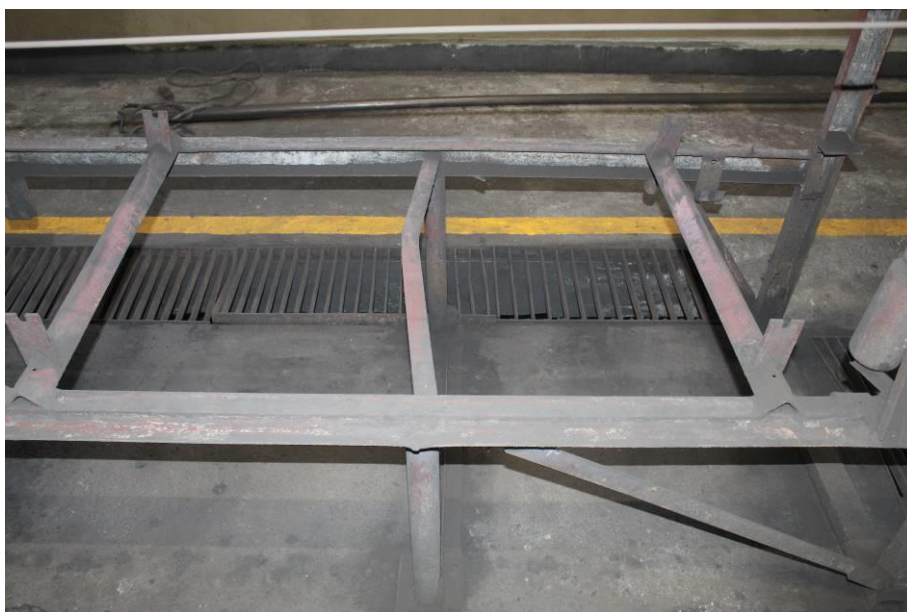
Fot. 20: Korozja i deformacja elementu estakady wewnątrz kotłowni
