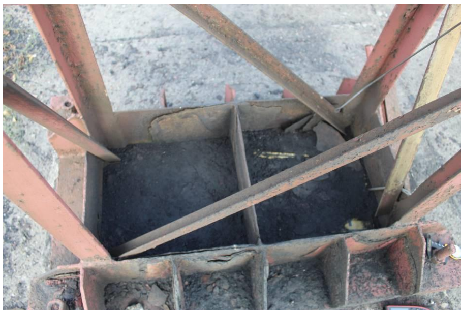
Fot. 7: Korozja elementów podstawy słupa
