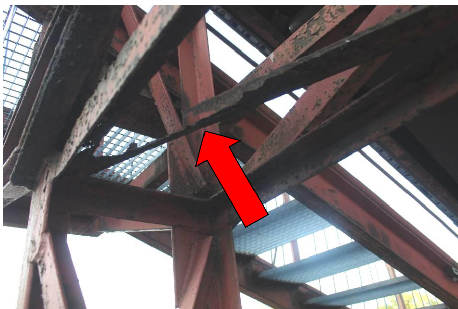
Fot. 8: Degradacja na skutek korozji skratowania poziomego słupa
