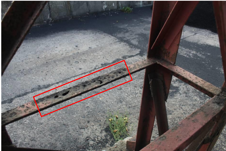
Fot. 5: Korozja wżerowa skratowania słupa
