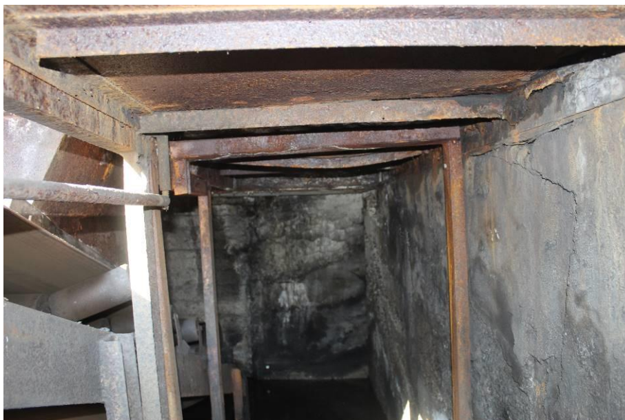
Fot. 19: Korozja i deformacja elementów nośnych pokrycia stalowego podestu w obrębie placu składowego węgla
