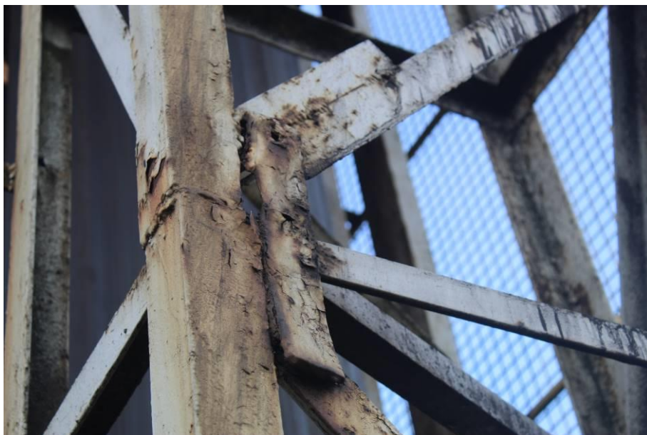
Fot. 13: Korozja i brak spoinowania blachy węzłowej słupa
