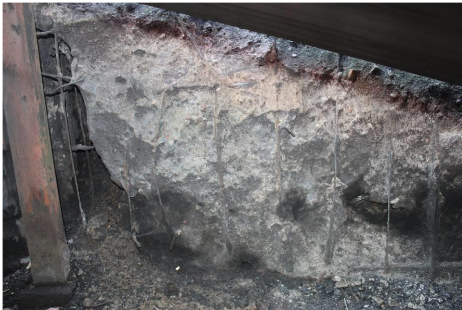
Fot. 17: Ubytki otuliny i korozja zbrojenia ściany żelbetowej poniżej poziomu terenu
