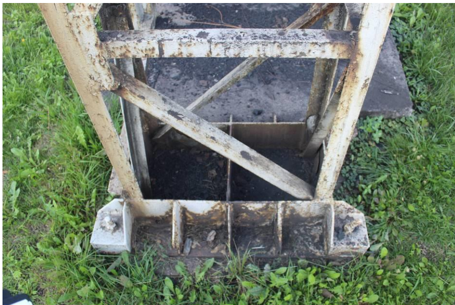
Fot. 12: Korozja elementów podstawy i skratowania słupa
