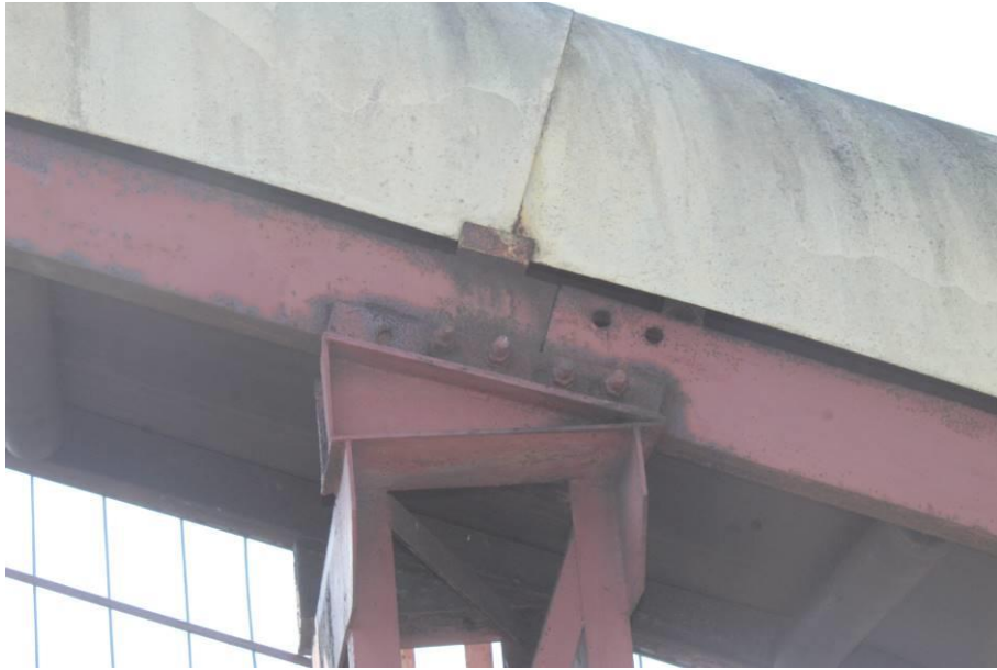
Fot. 21: Korozja w obrębie styku elementów nośnych estakady
