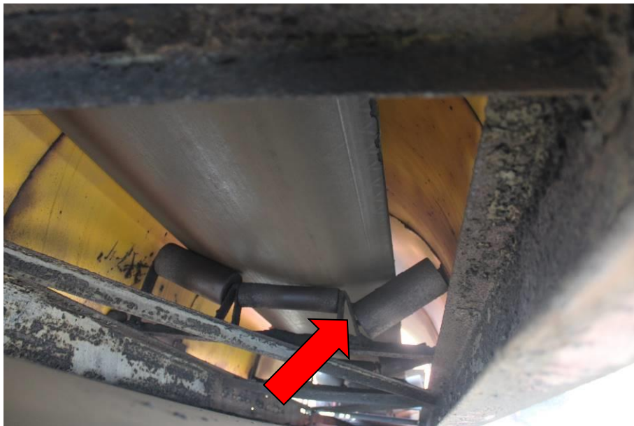
Fot. 11: Korozja elementów konstrukcji wsporczej przenośnika taśmowego wraz ze skratowaniem, uszkodzenie mocowania rolki taśmociągu
