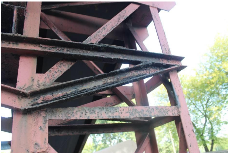
Fot. 6: Korozja elementów wsporczych biegu schodowego i skratowania słupa
