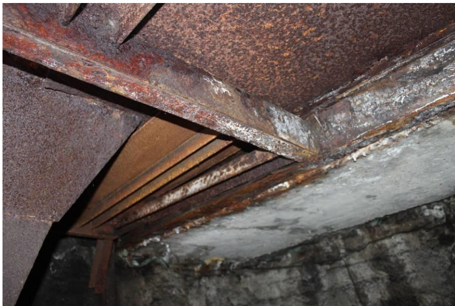
Fot. 18: Korozja elementów nośnych pokrycia stalowego podestu w obrębie placu składowego węgla
