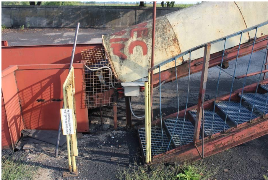
Fot. 9: Korozja elementów biegu schodowego i konstrukcji wsporczej przenośnika taśmowego
