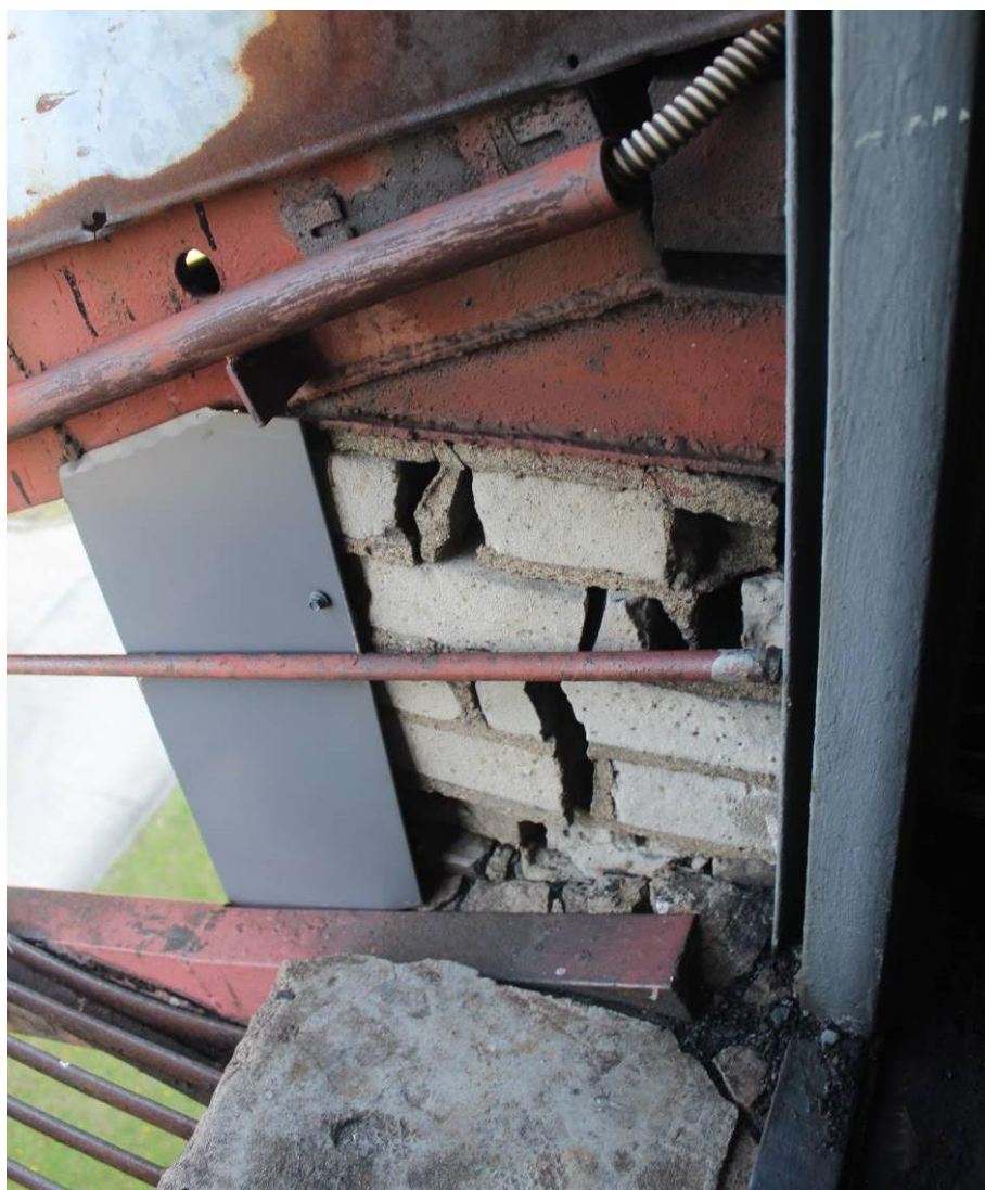
Fot. 15: Spękanie elementów murowych ściany kotłowni w miejscu oparcia estakady
