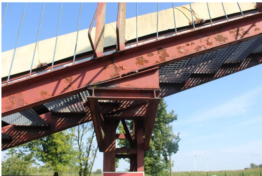
Fot. 10: Korozja elementów biegu schodowego i konstrukcji wsporczej przenośnika taśmowego
