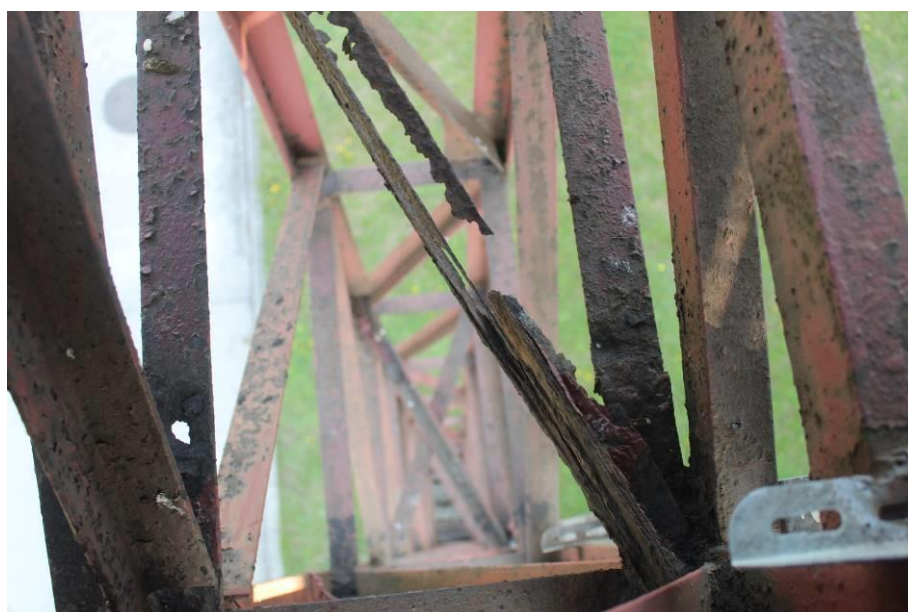
Fot. 16: Degradacja na skutek korozji skratowania poziomego słupa
