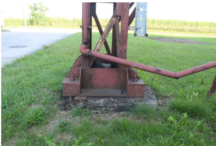
Fot. 14: Niesymetryczne ustawienie słupa kratowego na fundamencie
