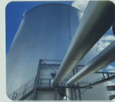
Thermal heat storage of 3000 m 3 (Klaipėda DH Company)
